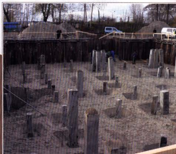
Fot. 1 | Widok na nieckę wykopu, widoczna ścianka szczelna oraz nierozkule głowice pali prefabrykowanych fundamentu
