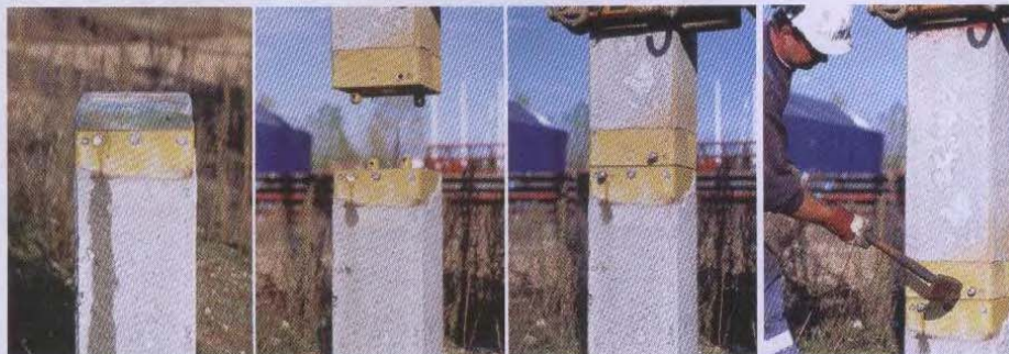
Fot. 2. Procedura łączenia pali prefabrykowanych o wymiarze 250x250 mm (od lewej: pal ze złączką, montaż kolejnego odcinka pala, założenie i dobicie bolców łączących)
