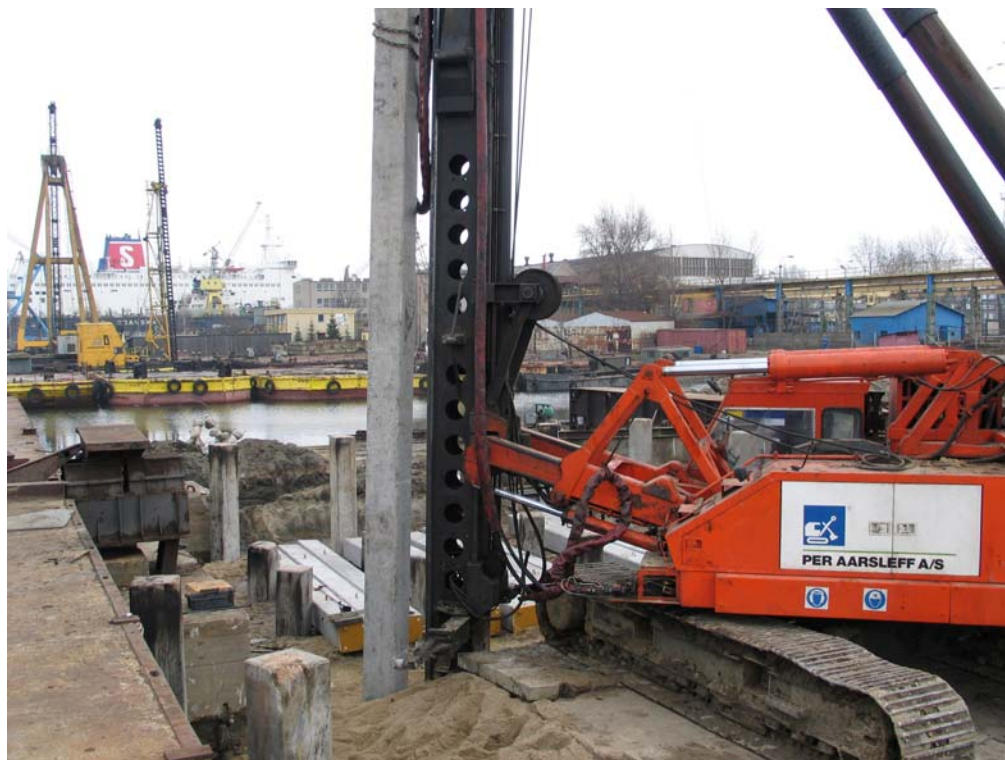
Rys. 7. Wbijanie pali prefabrykowanych 40x40 cm łączonych, pod Stanowisko Prób Obciążeń Żurawi Okrętowych MacGregora w Gdańskiej Stoczni Remontowej
