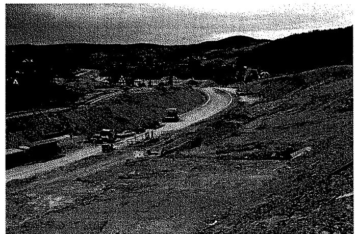
Rys. 7. Fragment odcinka drogi S77 objęty ruchami osuwiskowymi
